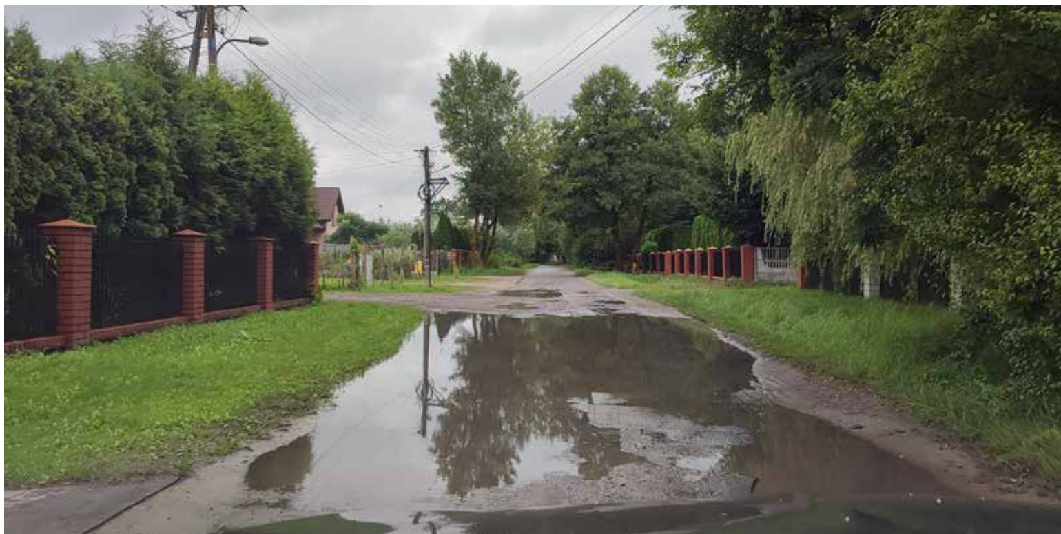
Niedokończony, kilkunastometrowy odcinek ul. Zagórzańskiej - codzienność w deszczową porę. Fot. Konrad Czapski
